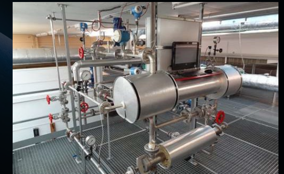
Échangeur de chaleur industriel vapeur saturée / eau de process
